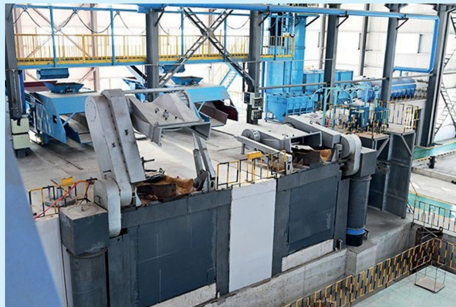
Загрузочное устройство плавильной печи.
